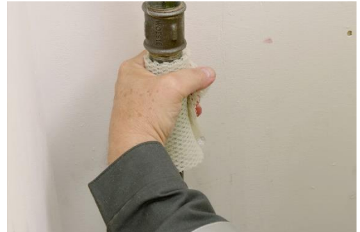
Foto 5 - Opruwen van een leiding
