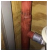
Foto 1 - Leiding met lekkende koppeling
